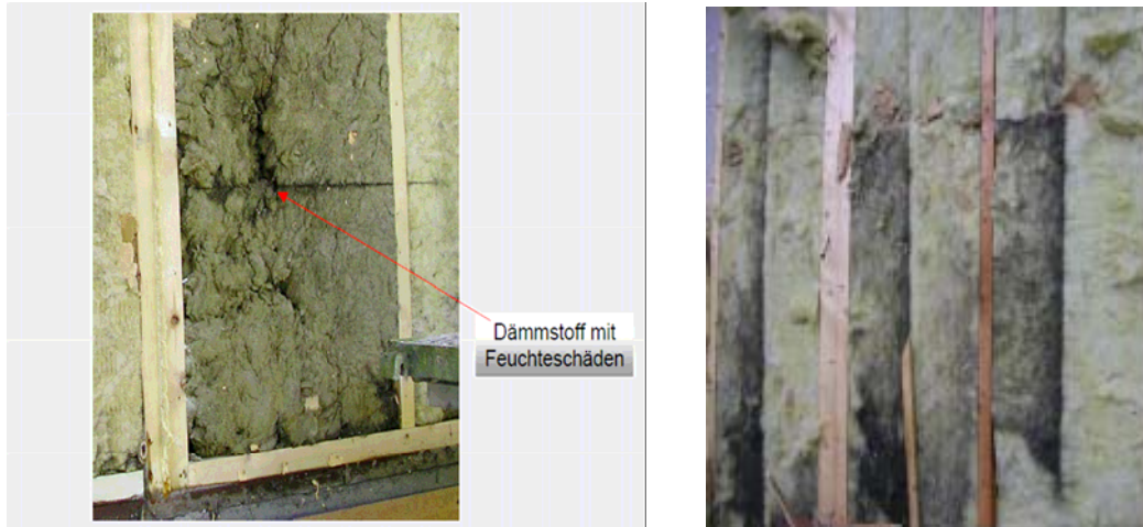
Abb. 6 Gefachedämmung mit Feuchteschäden
