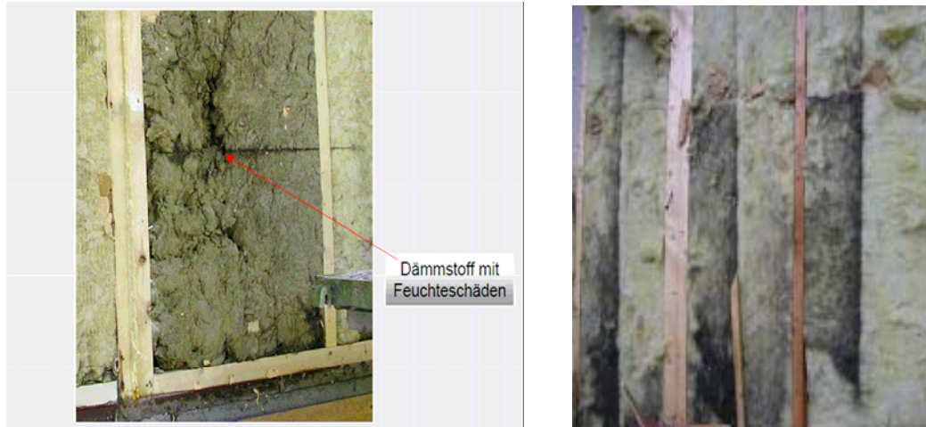
Abb. 6 Gefachedämmung mit Feuchteschäden
